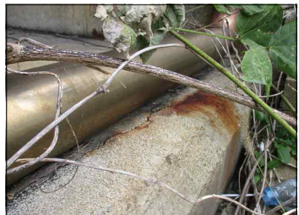
교대 콘크리트 박리(A2)
