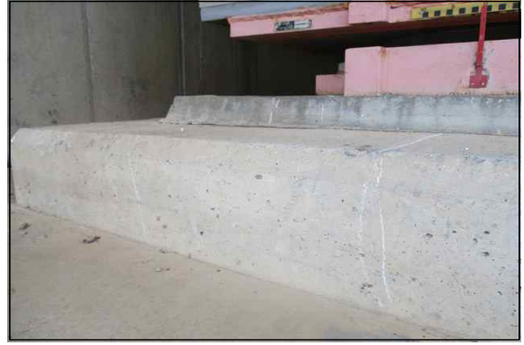
받침콘크리트 균열(A1 SH2)
