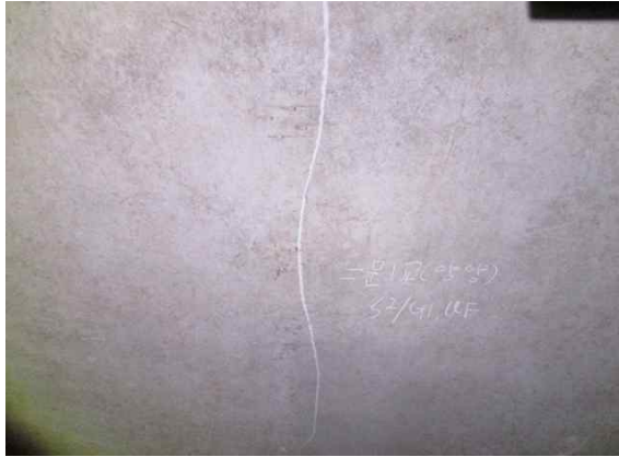
거더 내부 상면 균열(S2)
