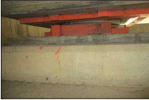
받침콘크리트 균열(A1 SH1)
