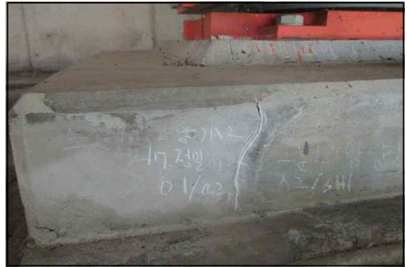
받침콘크리트 균열(A2 SH2)
