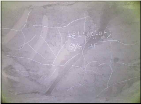
거더 내부 상면 망상균열(S5)
