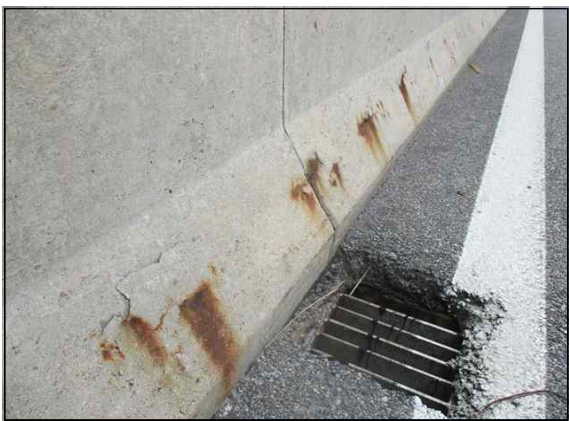
방호벽 들뜸 및 철근노출(S7)
