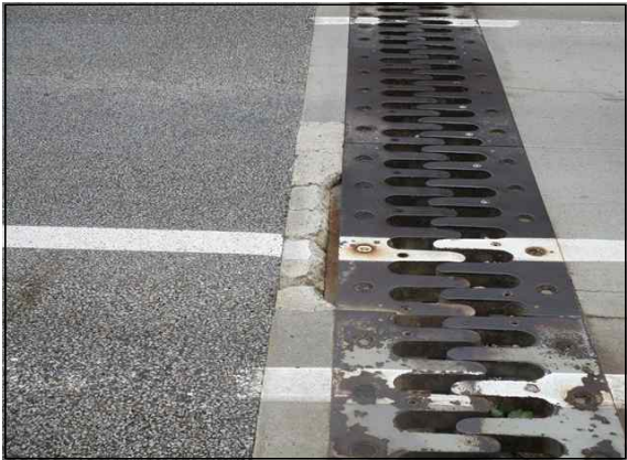
신축이음 후타재 파손(A2)
