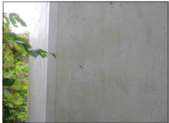
교각 기둥 균열(P6)
