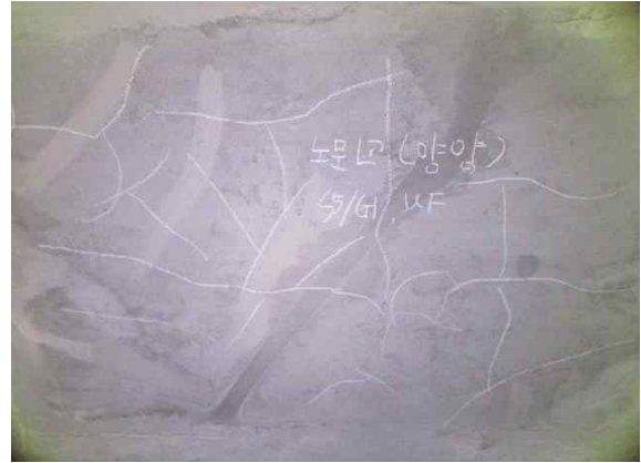
거더 내부 상면 망상균열(S5)
