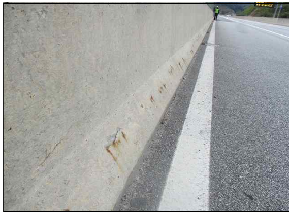
방호벽 들뜸 및 철근노출(S1)
