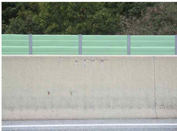
방호벽 중분대 균열(S7)
