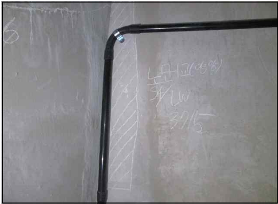
거더 내부 좌측면 들뜸(S4)
